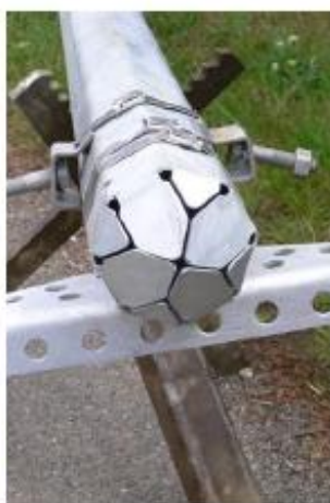
Poteau métallique obturé en usine, dont la fermeture n'est pas visible depuis le sol
