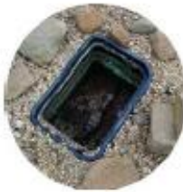
Les regards de compteurs d'eau doivent être obturés
