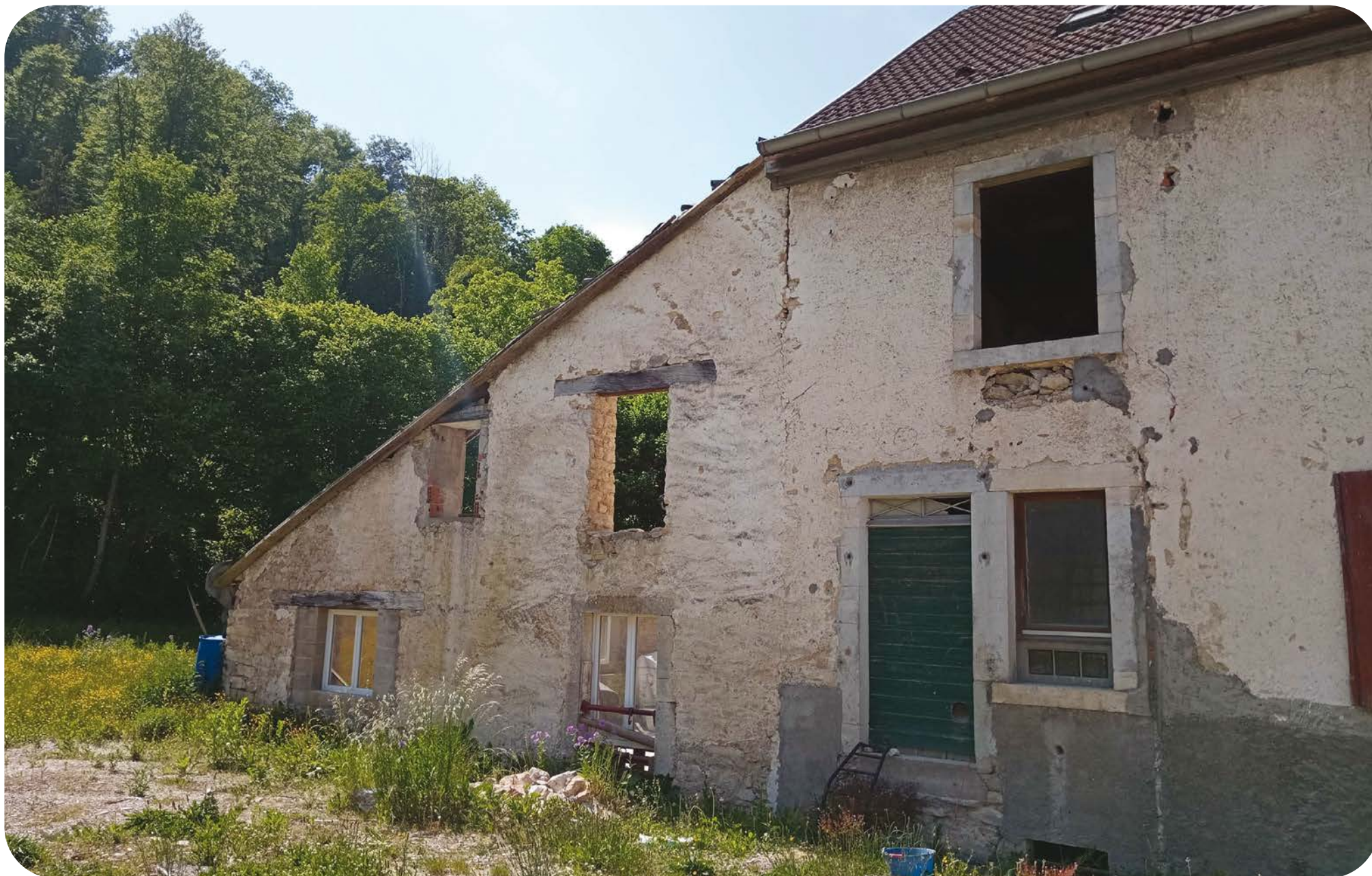
Meslières, bien en état d'abandon, Source : EPF Doubs BFC
